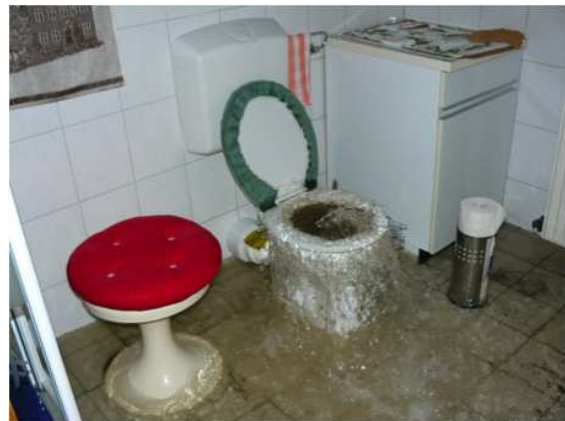
Zurückstauendes Wasser kann erheblichen Schaden anrichten.
